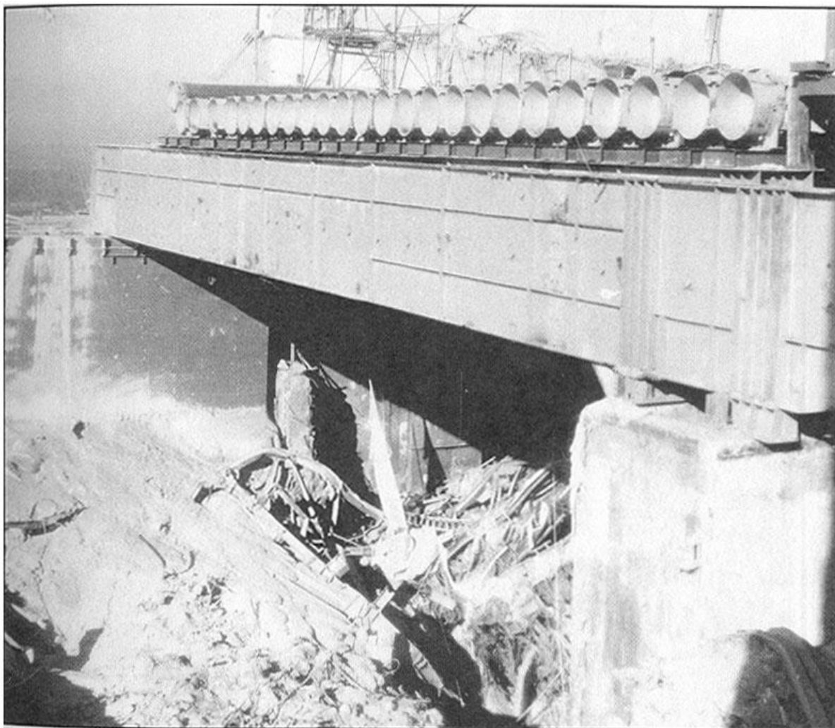
Вид со стороны машинного зала.
