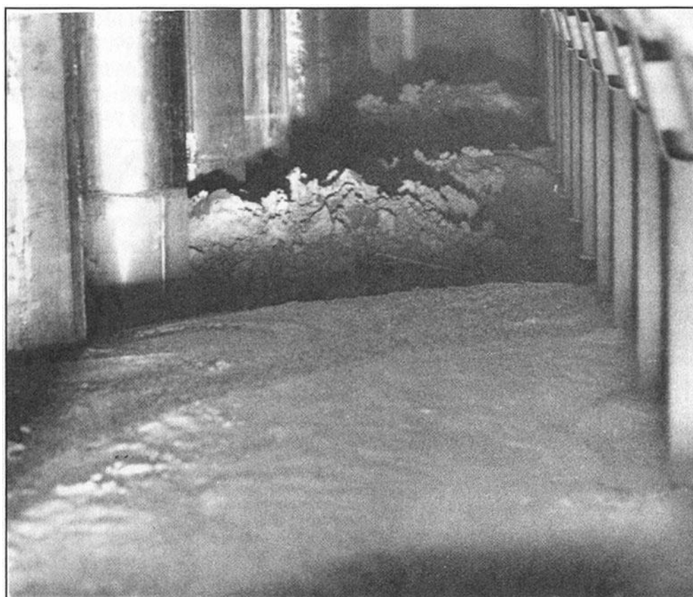
Освещенный канал между 3 и 4 блоками, ясно видны протечки бетона.
